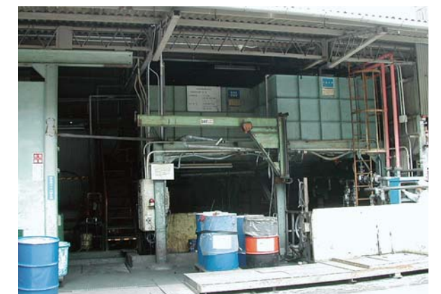
油水分離処理設備
